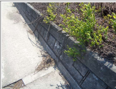
20 진입부 옹벽 균열 STA.0+055(2.0mm/0.6m)
