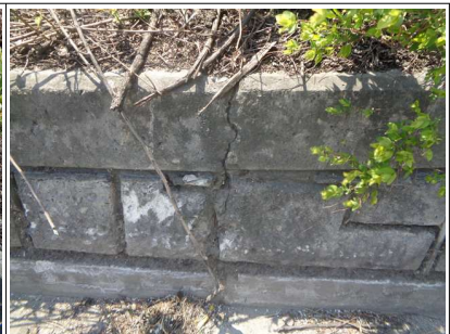
21 진입부 옹벽 균열 STA.0+055(2.0mm/0.6m)
