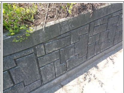
18 진입부 옹벽 균열 STA.0+040(2.0mm/1.2m)
