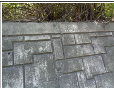
17 진입부 옹벽 균열 STA.0+020(1.0mm/2.1m)
